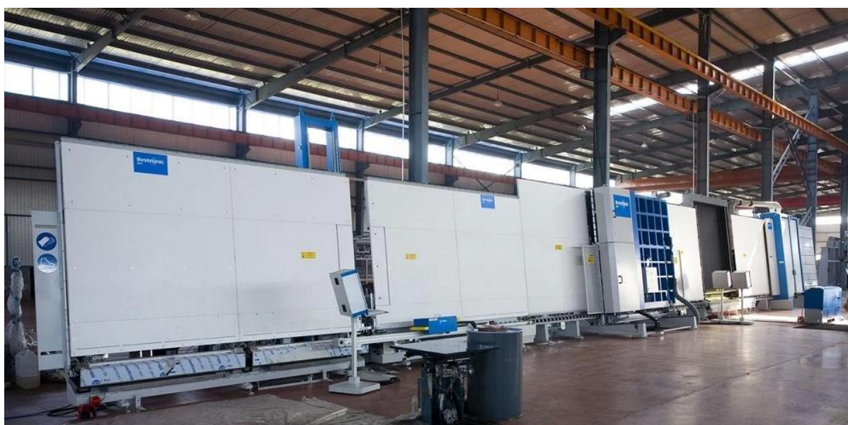
Linia do produkcji szkła elewacji:
